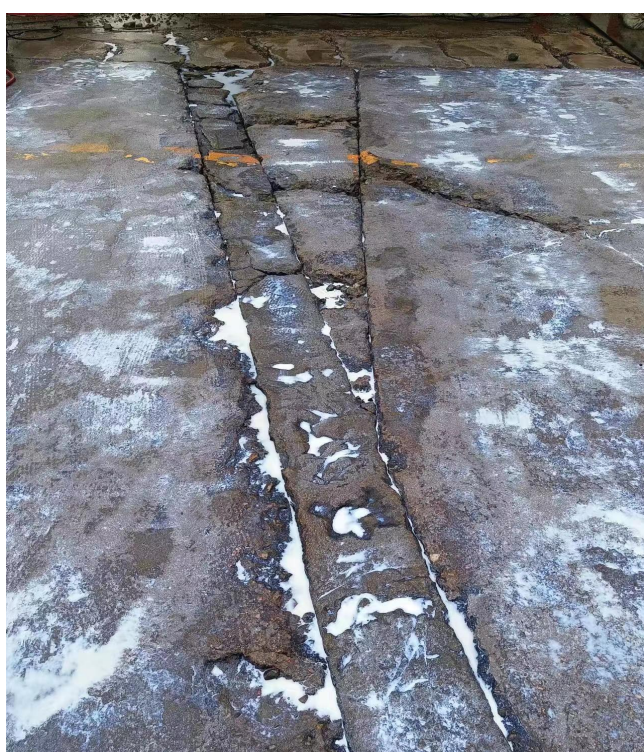
地面破损严重
