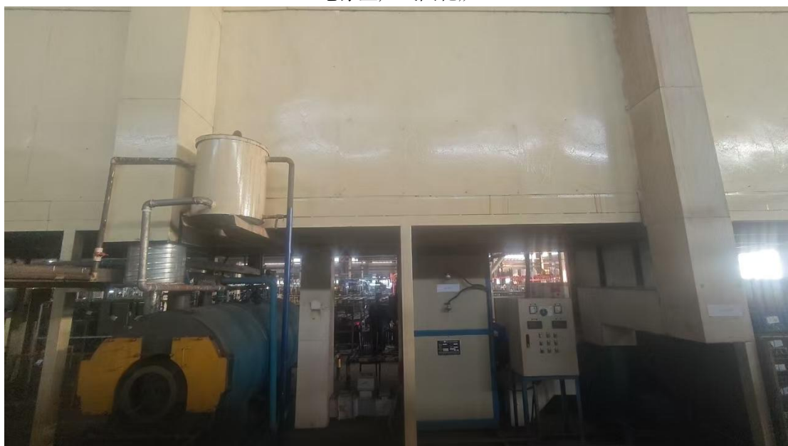
电泳生产线 RCO 装置
