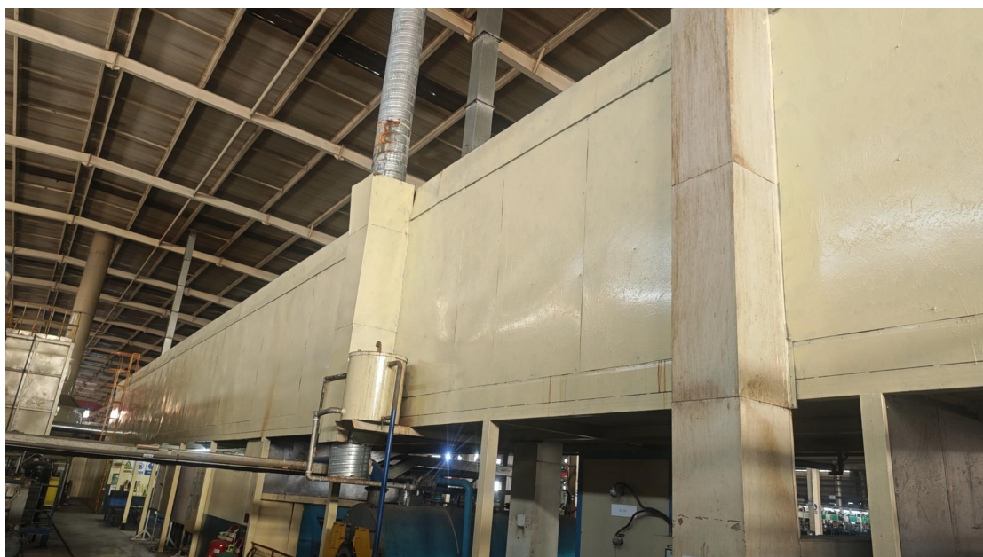
电泳生产线固化炉
